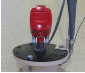
곡물 사일로에 설치한 사진
